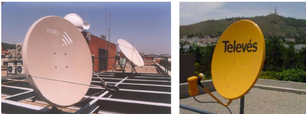
Figura 9. Parabólicas utilizadas inicialmente para distribuir el servicio de televisión por satélite (izquierda) y parabola y LNB nuevos (derecha).
