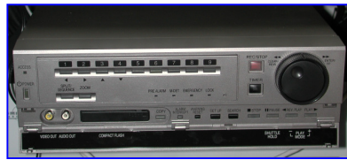
Fig. 7: Grabador digital de cámaras con servidor de vídeo.
