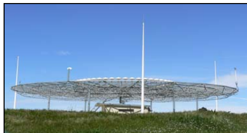
Fig. 1.3.2.1. DVOR en El Perdón (Navarra).
