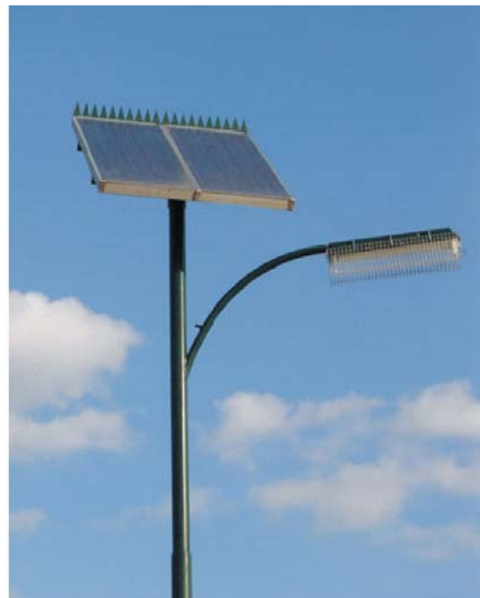
Figura 27. Alumbrado mediante módulo fotovoltaico
