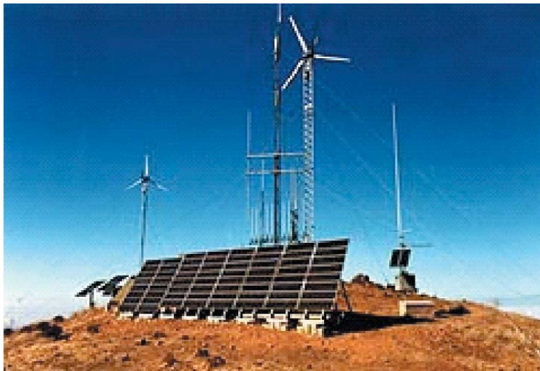
Figura 28. Estación de telecomunicación alimentada con Energía Solar Fotovoltaica
